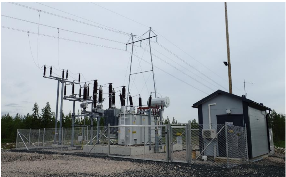
Kuva 4-9. Esimerkki tuulivoimapuiston sähköasemasta 110 kV. (kuva Minna Takalo/FCG).
